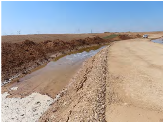
Zonas encharcadas tras tormentas, junto a los caminos construidos.
