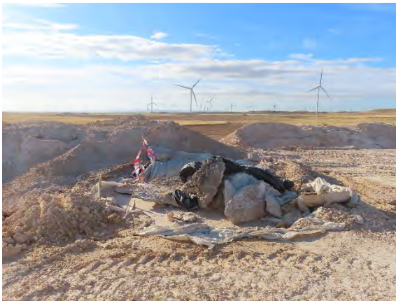
Pozo de lavado de hormigoneras desmantelado, previamente a su retirada y entrega a gestor autorizado.
