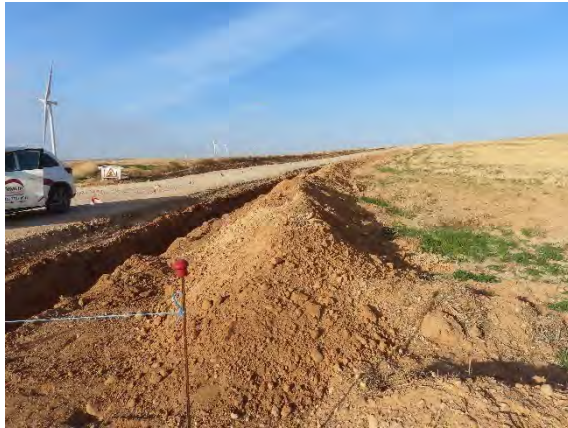
Acopio de tierras inertes de la excavación de la zanja eléctrica sobre el cordón de tierra fértil separado previamente.
