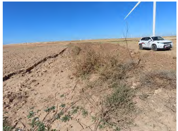
Acopios de tierra de la excavación de la zanja eléctrica depositados sobre la vegetación natural del ribazo.
